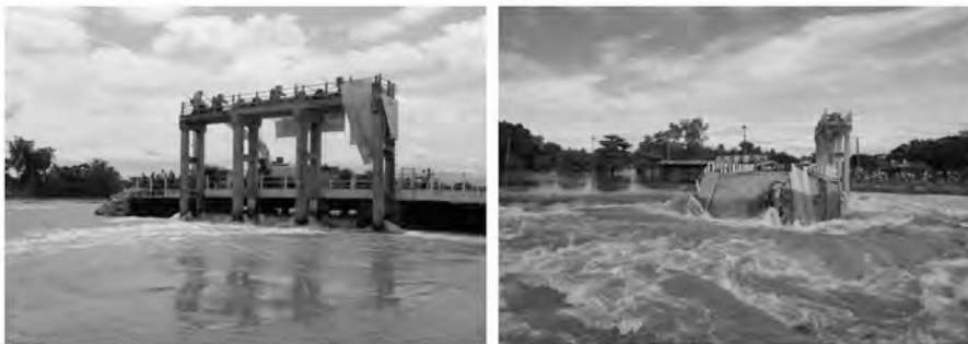
รูปที่ 1 ลักษณะการพังทลายของคันดิน ประตูระบายน้ำบางโฉมศรี เมื่อวันที่ 13 กันยายน 2554 (ที่มา: http://www.posttoday.com )
