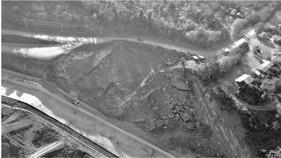
รูปที่ 9 ลักษณะการพังทลายของมวลหินบนที่ลาดชัน บริเวณฐานยันฝั่งซ้าย
