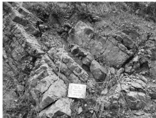
รูปที่ 6 พื้นที่ลาดไหลเขาบริเวณฐานยันฝั่งขวาของเขื่อน (เสถียรภาพลาดไหลเขาคุณภาพดี)
