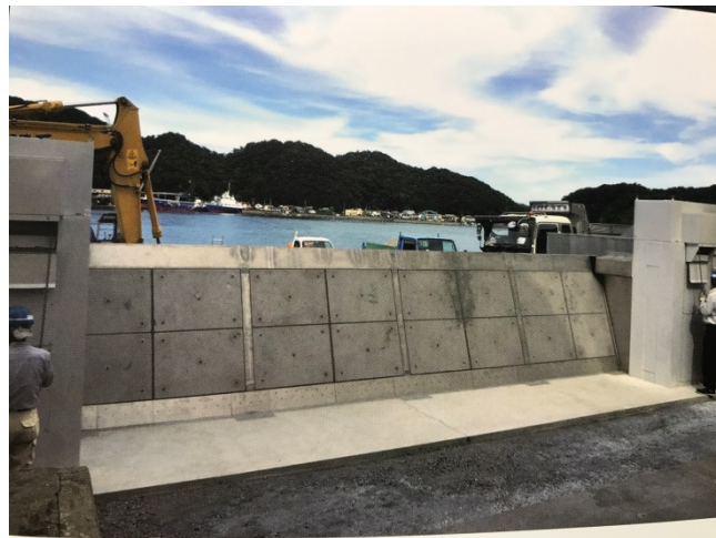
Flap gate ซึ่งปิดเปิดได้เองด้วยแรงดันน้ำ
